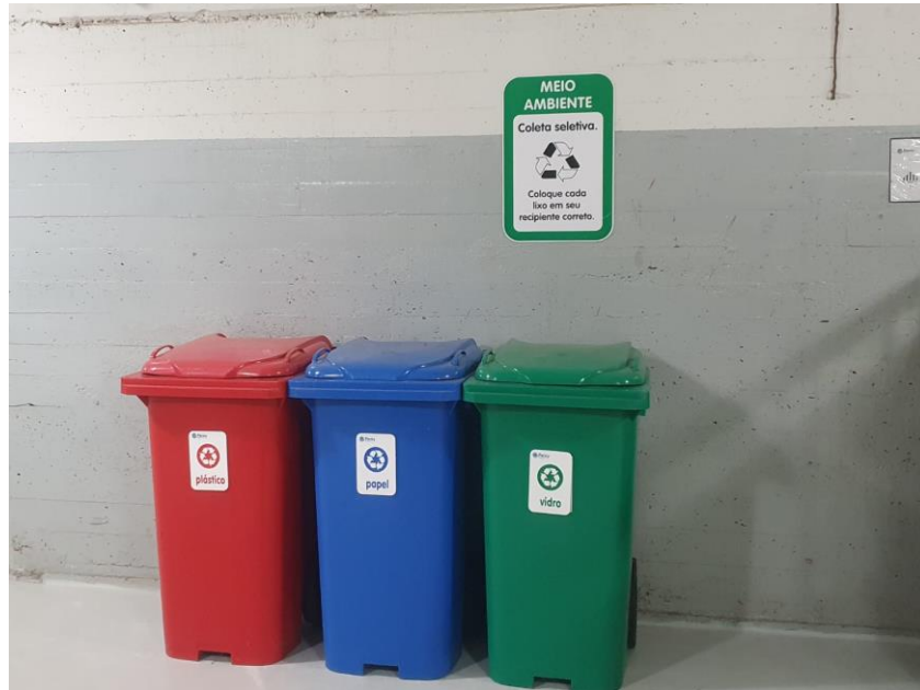
Foto 6.8-2 Coletores localizados no piso 4.
