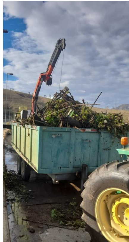
Foto 6.1-6 Carregamento de resíduo do Log Boom e grades da Casa de Força
