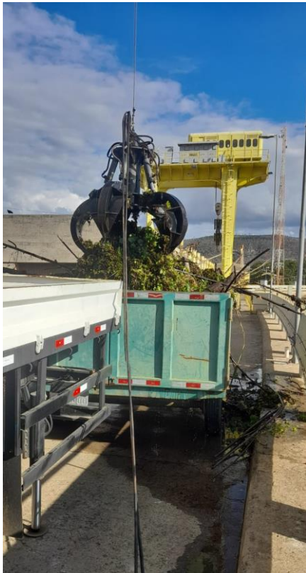
Foto 6.1-5 Carregamento de resíduo do Log Boom e grades da Casa de Força
